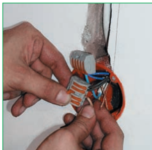
▲ Электрические соединения в сервисной коробке
